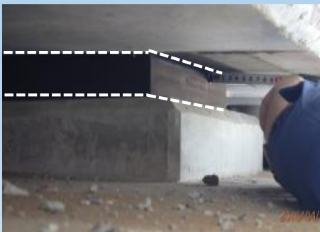
ゴムパッドの抜け出し
