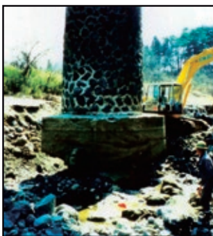
基礎が浮いた不健全な状態
