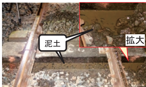
劣化したバラストの例
