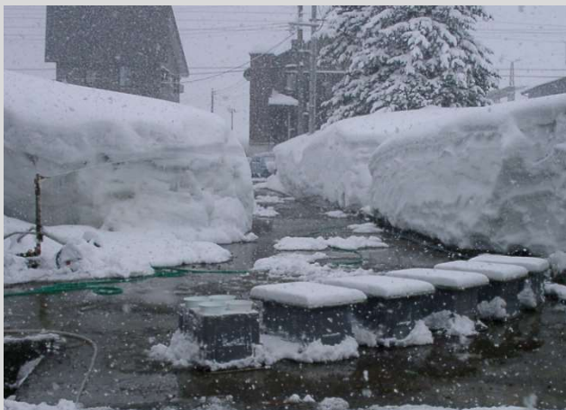
スプリンクラー散水試験
