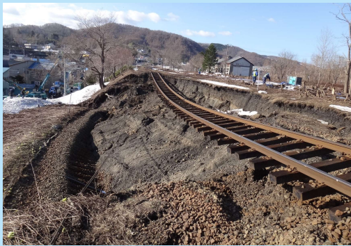
図1 融雪期の盛土崩壊(融雪災害)事例
