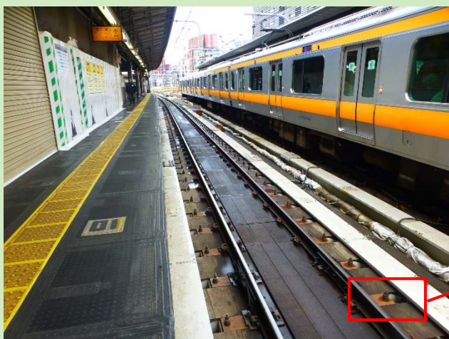
(駅構内における敷設状況)
