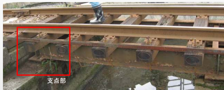
ビーム橋梁支点部の疲労き裂
