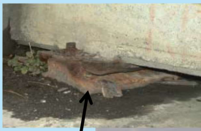
支承部の腐食
