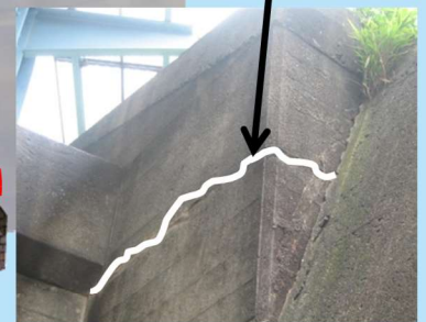
橋台のひび割れ
