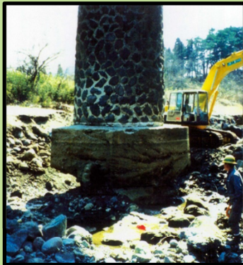
基礎が浮いた不健全な状態
