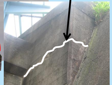
橋台のひび割れ
