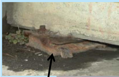
支承部の腐食
