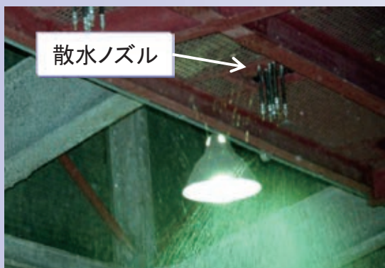
ノズルからの散水状況
