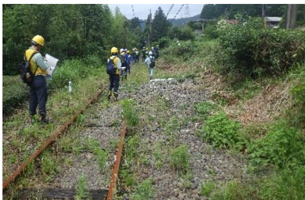
土砂流入箇所の目視（台風被災関連）
