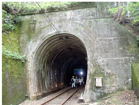
トンネル坑口劣化箇所の目視（劣化補修関連）
