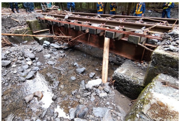
溪床埋没箇所の目視（台風被災関連）
